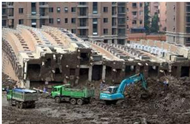
图 0-4 上海一幢高楼整体倒覆
